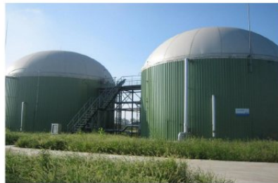
가스 저장용 상부 탱크허베이 용량: 1500m 3 *2
