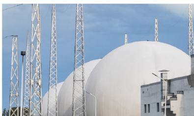
北京排水集団・北京清河下水処理 ダブルメンブレンガスホルダー 容量：5,000 m 3 × 3基
