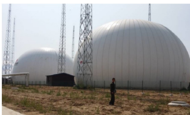
旗幟乳業・張北乳粉プロジェクト ダブルメンブレンガスホルダー 容量：20,000 m 3
