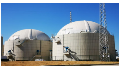
安徽・グリーン電力 タンク上設置型 2,000 m 3 × 3基、1,500 m 3 × 2基
