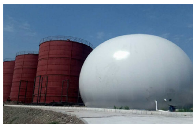
青島・バイオマスエネルギー ガスホルダー容量：20,000 m 3
