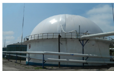
蒙牛集団・塞北第1期 牛ふん尿処理 2,000 m 3 タンク上設置型（改修） 2014年3月竣工
