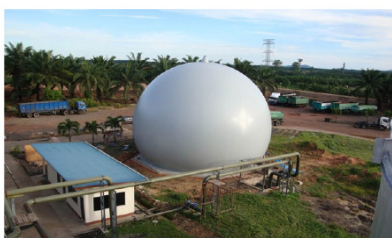
インドネシア・パーム油廃水処理 バイオガス発電プロジェクト 容量：1,000 m 3
