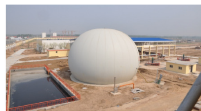
山東省徳州市 バイオガス発電利用プロジェクト 容量：3,000 m 3
