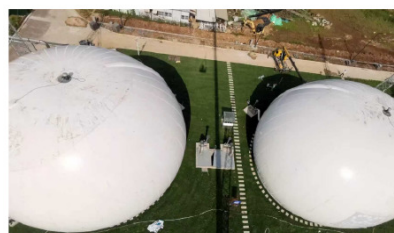
北京吉成・食品廃棄物 バイオガス資源利用 容量：3,000 m 3 × 2基
