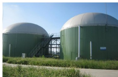
Tangki atas penyimpan gas Hebei Volume: 1500m 3 *2
