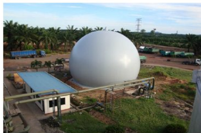
Indonesia Biogas PowerProyek Generasi Volume: 1000m 3
