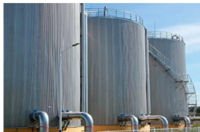
Darurat Mongolia Dalam tangki air pemadam kebakaran Volume: 1500m 3 *3
